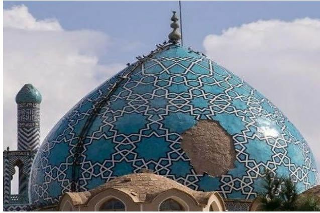
شکل ۱۸- ریزش در قسمتی از گنبد شاه نعمت‌الله ولی. Figure 18- Falling in a part of the dome of Shah Nematullah Wali.
